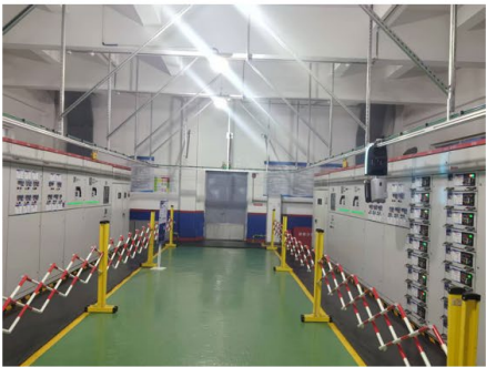
配电室现场应用
